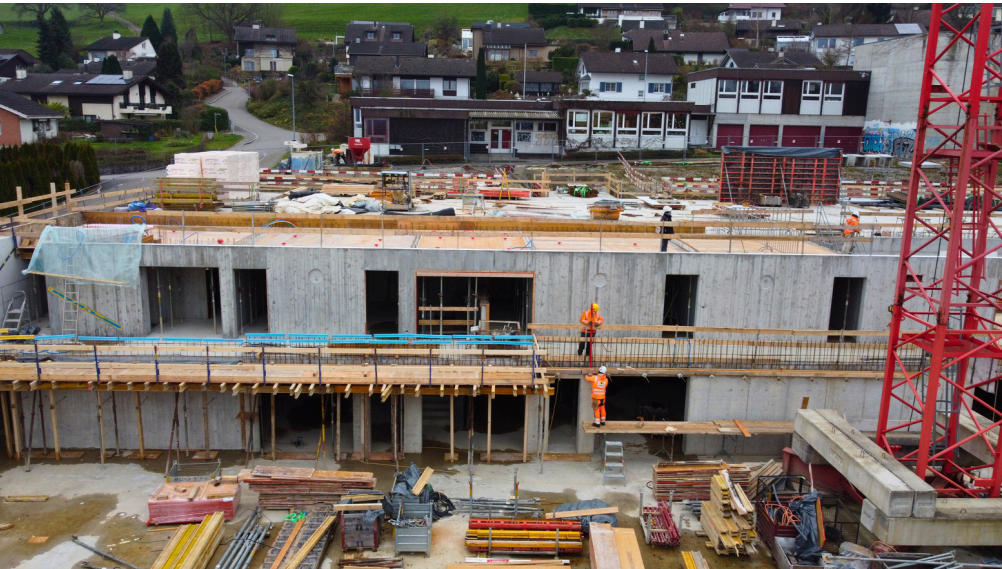
Neubau Turnhalle Rüdigen, Architekten: Buchberg, moos giuliani herrmann architekten ag, Planer: Landolt + Co. AG Kleinandelfingen, © Fotos: Andrea Schären, Landolt + Co. AG
